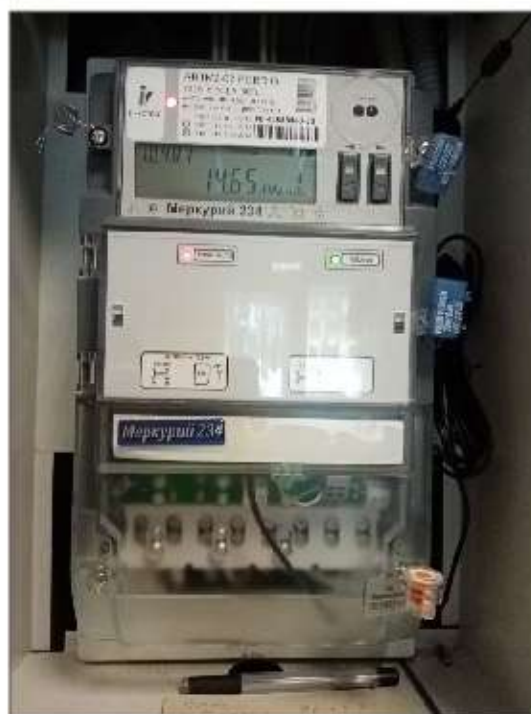
Рисунок 5.3.15 – Прибор учета электрической энергии
