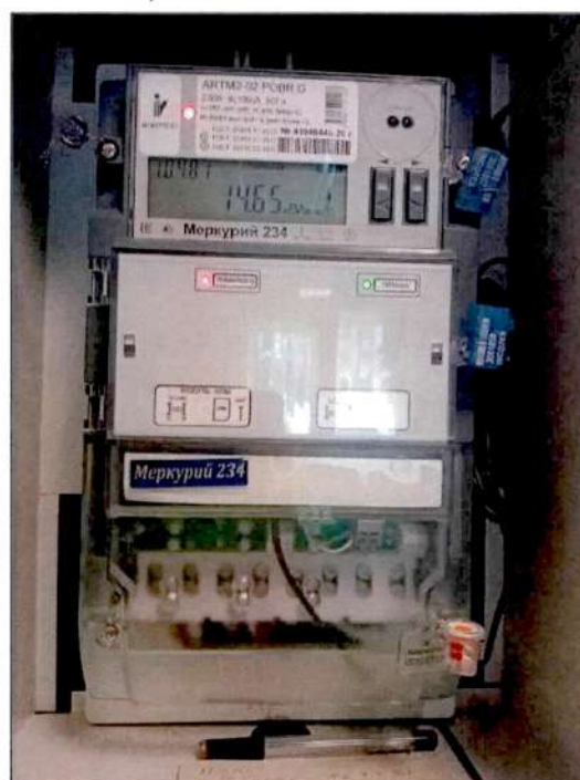
Рисунок 5.3.15 – Прибор учета электрической энергии
